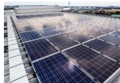
太陽光パネル
