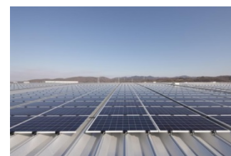
太陽光パネル
