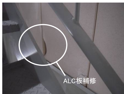
【屋内非常階段間仕切り板破損】
