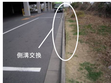
【縁石側溝損傷】
