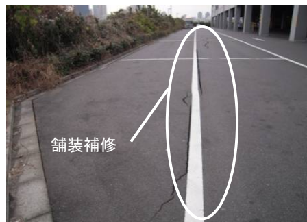
【アスファルト舗装ひび割れ】
