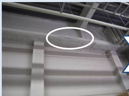
耐火被覆一部剥離
