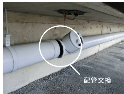
【雨水配管破損】
