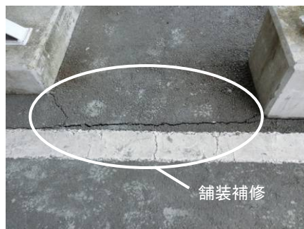
【アスファルト舗装ひび割れ】
