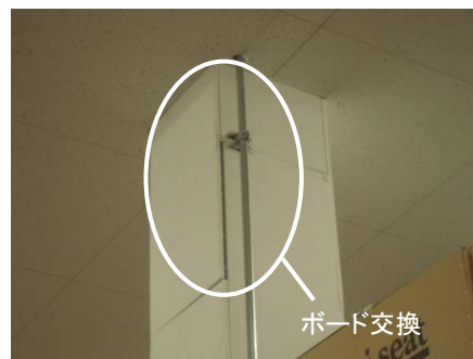
【柱耐火ボード破損】
