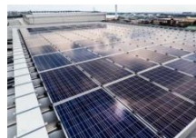
太陽光パネル
