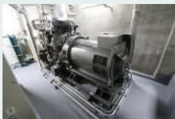
増設発電機本体
