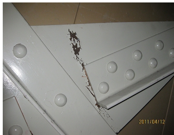
↑ 震動による中央プレート部分塗装剥離
