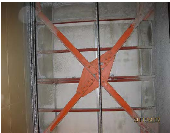
↑ 適正状態のブレースおよび中央プレート
