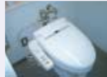
オフィスビル9物件で197台の新規設置
