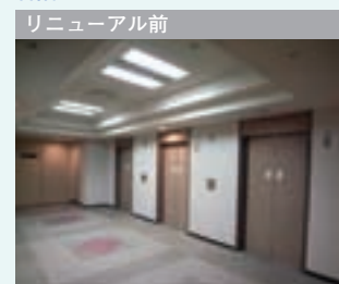
各階エレベータホール
