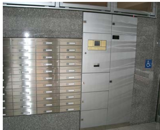
宅配ボックス
