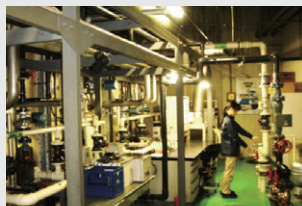
・中水プラント (厨房排水の再利用システム)
