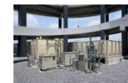
地下水供給設備
