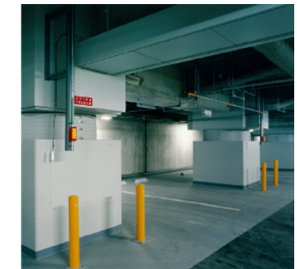
免震装置設置状況(地下1階)
