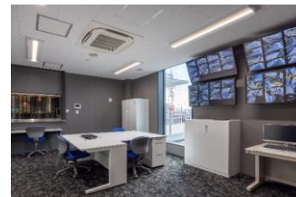
■ 防災センター
