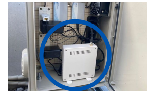
デマンドコントロール(集中制御装置)
