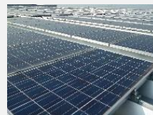
太陽光発電システム
