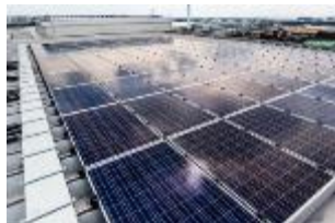
太陽光パネル
