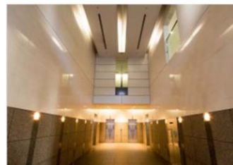
エントランスホールへのLED導入 (広尾MTRビル)
