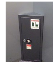
EV非常用品収納ボックス (Daiwa麻布テラス)
