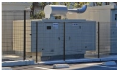
非常用発電機
