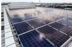
太陽光パネル
