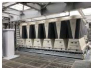
高効率熱源機器の導入 (新横浜TECHビル)
