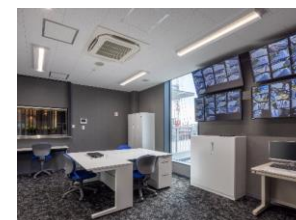
■ 防災センター
