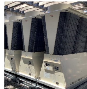
(冷温水チラー)
