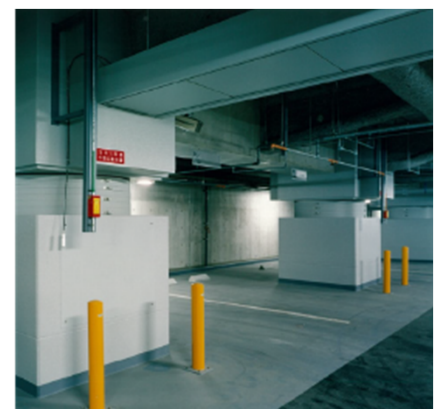
免震装置設置状況(地下1階)
