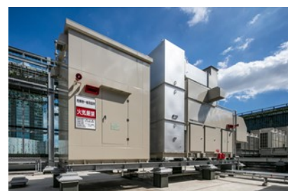
▲非常用発電設備
