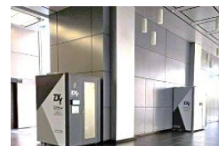
ZXY BOX設置 (Daiwa狹達ビル)
