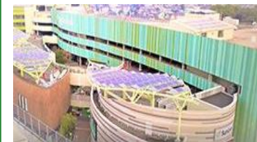
太陽光発電システム
