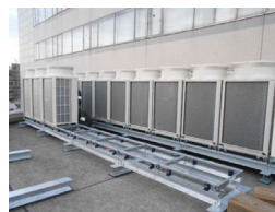
空調設備の更新
