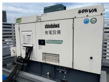
本導入対象の非常用発電機
