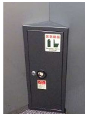
EV非常用品収納ボックスの設置 (Daiwa麻布テラス)
