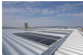
屋上太陽光パネル
