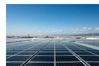
太陽光発電設備
