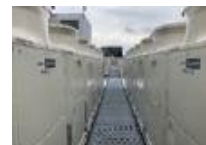
空調設備の更新 (Daiwa銀座ビル)
