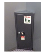
EV非常用品収納ボックス (Daiwa麻布テラス)
