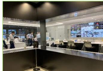
【防災センターの見せる化】
