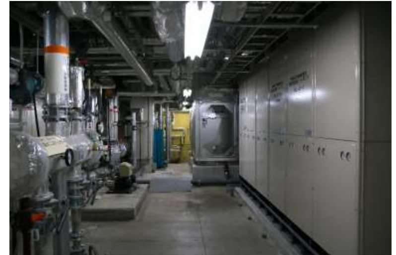
地中熱や温泉排熱を空調や給湯の熱源にするヒートポンプ設備
