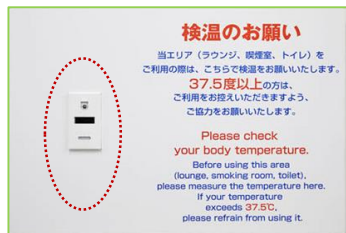
【共用部入口の検温器設置】
