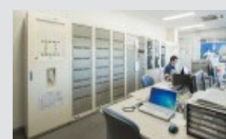
24時間365日稼働の 防災センター
