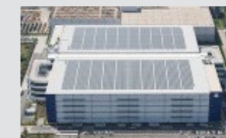
再生可能エネルギー活用 のための太陽光パネル
