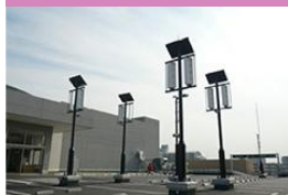
風車とソーラーパネルのハイブリッド型発電設備の設置
