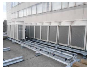
空調設備の更新
