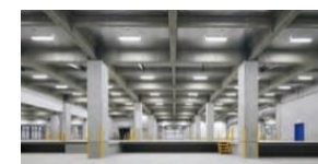
LED照明の導入
