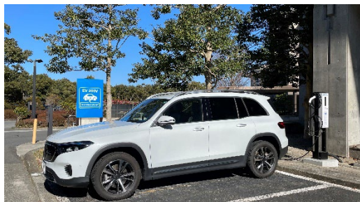
EVチャージステーションの導入 (ヒルトン小田原)
