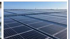
屋上太陽光パネル
