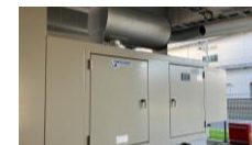
非常用発電設備
