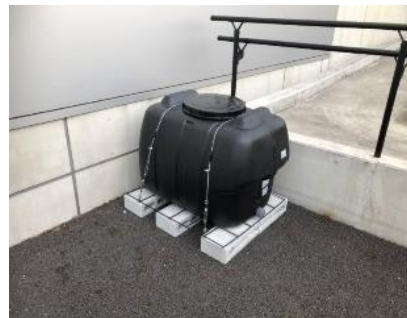
雨水貯水タンクを設置し、植栽水やりや外構の水撒きなどへ雨水を再利用
