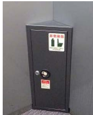
EV非常用品収納ボックス (Daiwa麻布テラス)
