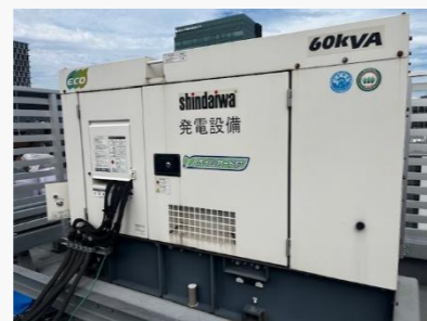
導入対象の非常用発電機（レジディア大手町北）
