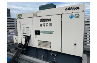
対象の非常用発電機
