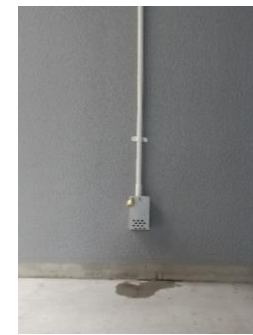
浸水センサーの設置
