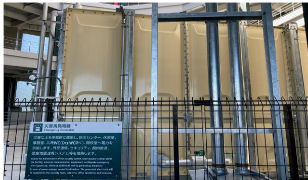
長時間稼働可能な非常用発電機の設置により、事業継続性向上をサポート
