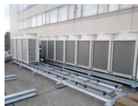
空調設備の更新
