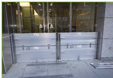
【防潮設備の設置】（NBF東銀座スクエア）
