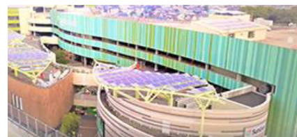
太陽光発電システム
